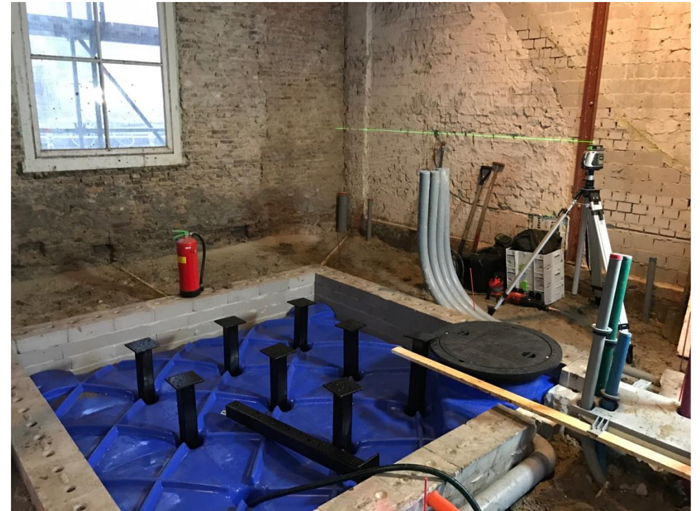
Ondergrondse regenwateropslag (3000 liter)
